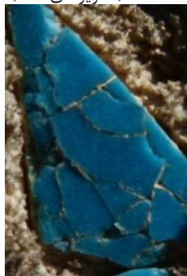
تصویر ۶. نفوذ رطوبت از طریق درزهای بین کاشی و ایجاد ترک در سطح لعاب بر اثر تنش بین لعاب و بدنه (نگارندگان).
